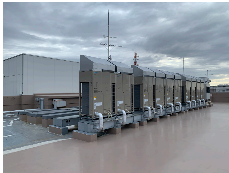
室外機群 施工後
